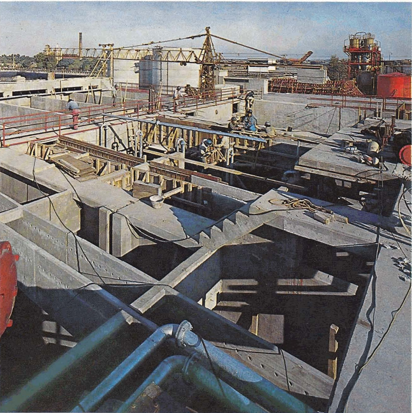
YPF - Piletas decantadoras y filtrado de agua en Planta de Tratamiento de Agua en Destilería La Plata.
